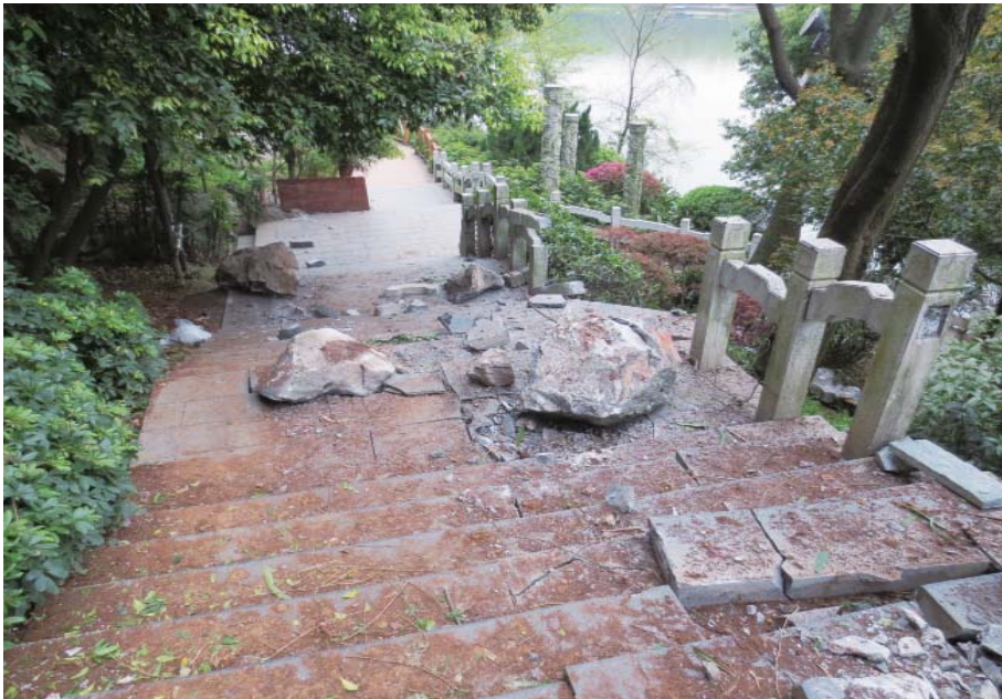
“3.19”桂林市叠彩山木龙洞岩质崩塌现场
