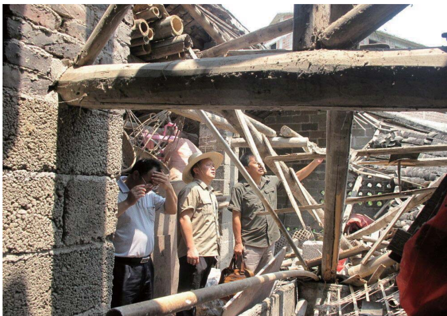
技术人员积极开展“7.31 苍梧地震”灾后地质灾害应急排查工作
